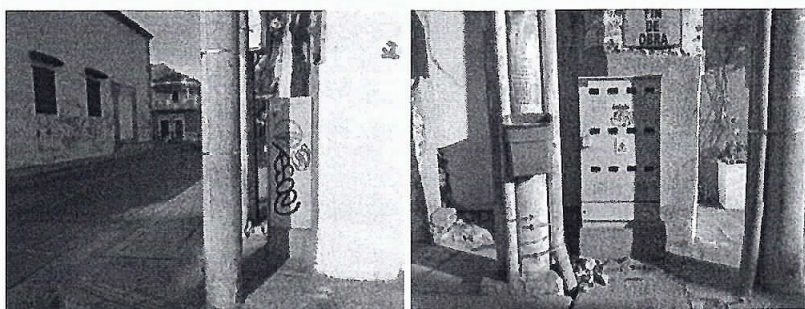
Instalaciones de gabinetes de servicios públicos en las fachadas de los predios
