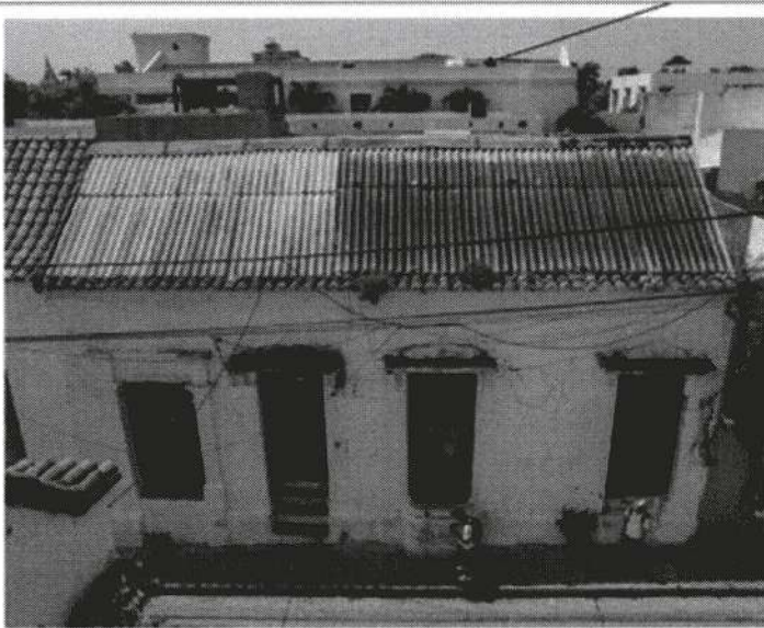
Vistas de cubiertas y segundos pisos en predio Multifamiliar colindante al predio en estudio, que sustentan nuestra propuesta arquitectónica.
